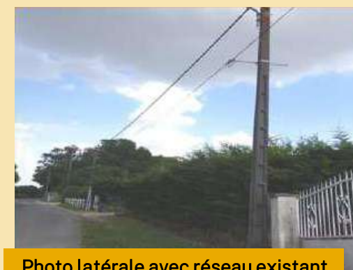
Photo latérale avec réseau existant
